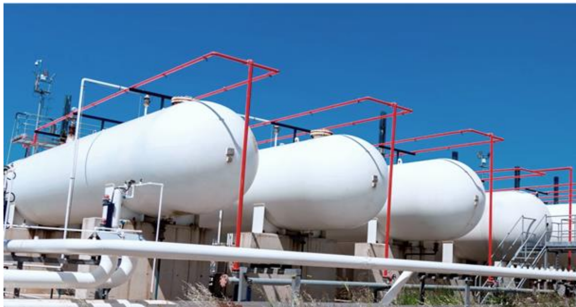
Модернизация резервуарного парка хранения газа, оптовой торговли пропан-бутан ООО «МОСТЕК»
